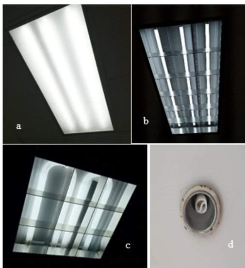
Figura 4: Tipos de lámparas en el edificio 2: a) Tubos Fluorescentes b) Tubos LED c) Tubos-U Fluorescentes d) Bobillos Fluorescentes.
