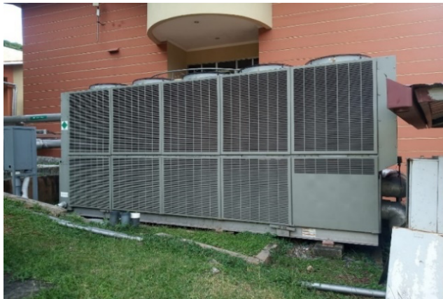
Figura 5: Chiller del Edificio 2.
