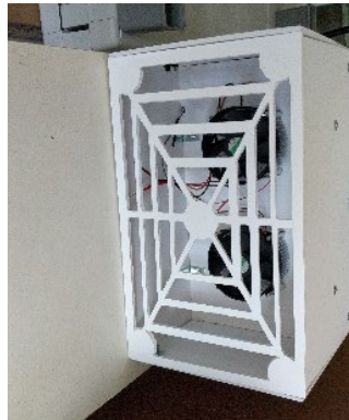
Figura 22. La parte trasera debe tener una mayor área de flujo para que el calor se disipe. Fuente: Propia.
