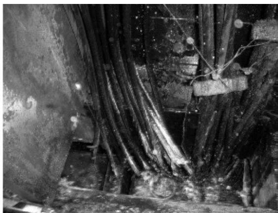
Figura 1 Cables fundidos en la acometida de un rascacielos, bajando desde el transformador principal
