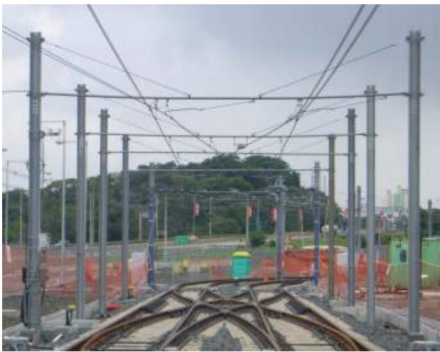
Figura 3. Postes de soportar catenarias. Ingeniería conceptual Línea 2. Especificaciones funcionales, técnicas y contractuales. Tomo II. Equipamientos [37].
