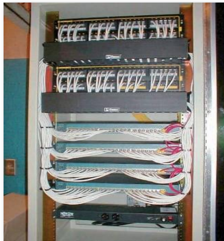
Figura 6.: Vistas de un rack para cableado estructurado.
