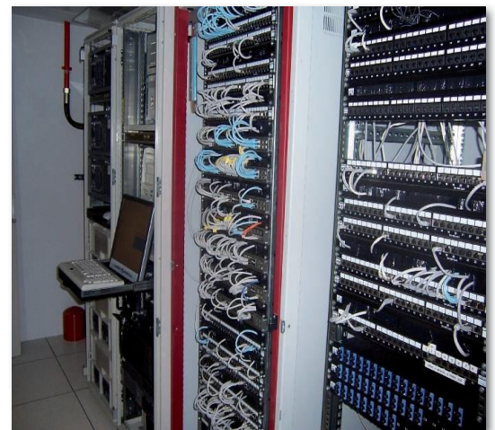
Figura 4.: Vista de un cuarto de comunicaciones instalado con cableado estructurado y certificado.
